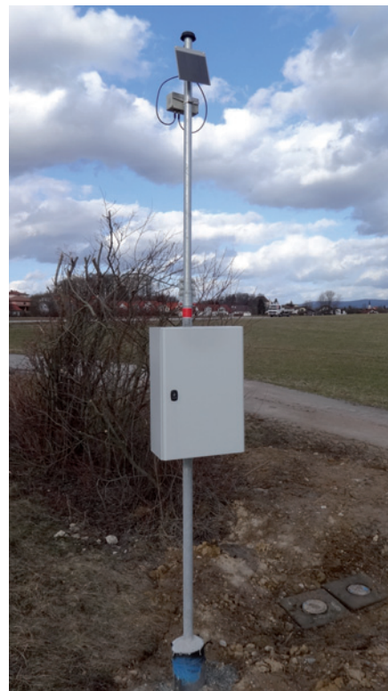
Übertragungstechnik (im Kasten) mit Solarpaneel zur Stromversorgung
