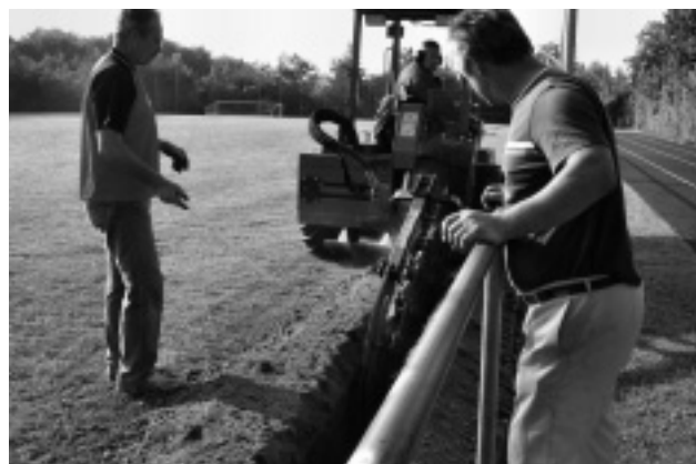
Zwischenzeitlich wurde die Bewässerungsanlage in Betrieb genommen.
