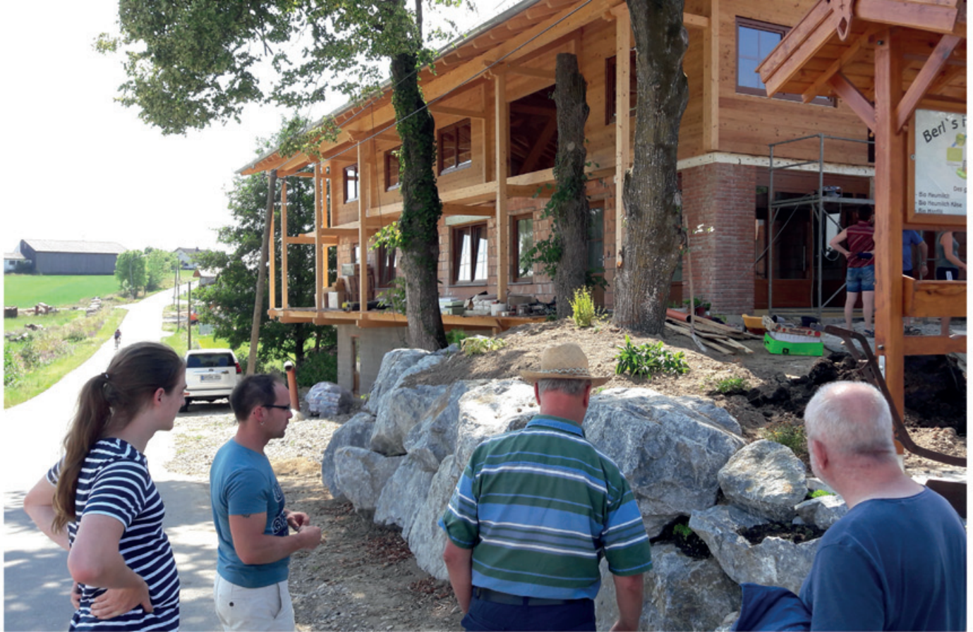
Markus Berl 2.v.l. führt durch das Gebäude, in dem die Käserei, der Reifekeller für den Käse und der Hofladen ihren Platz finden werden.
